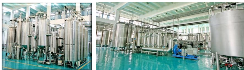
图 1 中药提取物生产的微滤-超滤-纳滤等膜集成工艺车间
